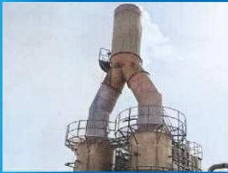
排煙脱硫装置
