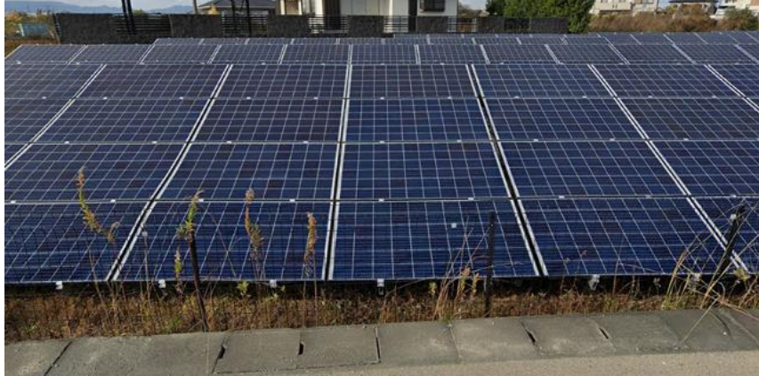
購入した太陽光発電設備
