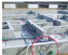
ベタ基礎と床下配管
