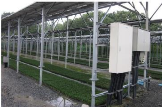
四日市市山田町 1.2MW
