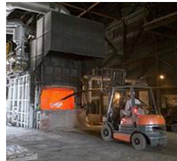
リジェネレーションバーナー が導入された溶解炉
