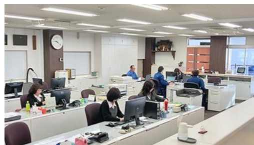
本社事務所の LED 照明
