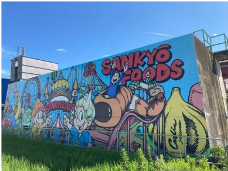
同社工場の排水処理設備(側面)
