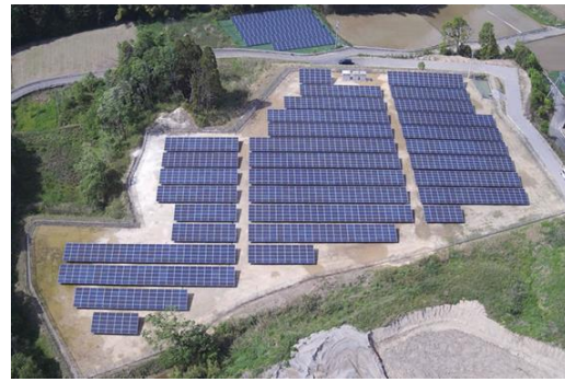
鈴鹿市国分町太陽光発電設備
