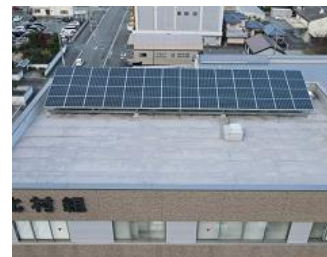
本会社屋の太陽光発電システム
